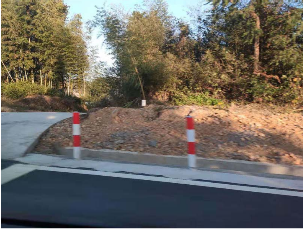
图4-1 已实施的道路南侧排水边沟
